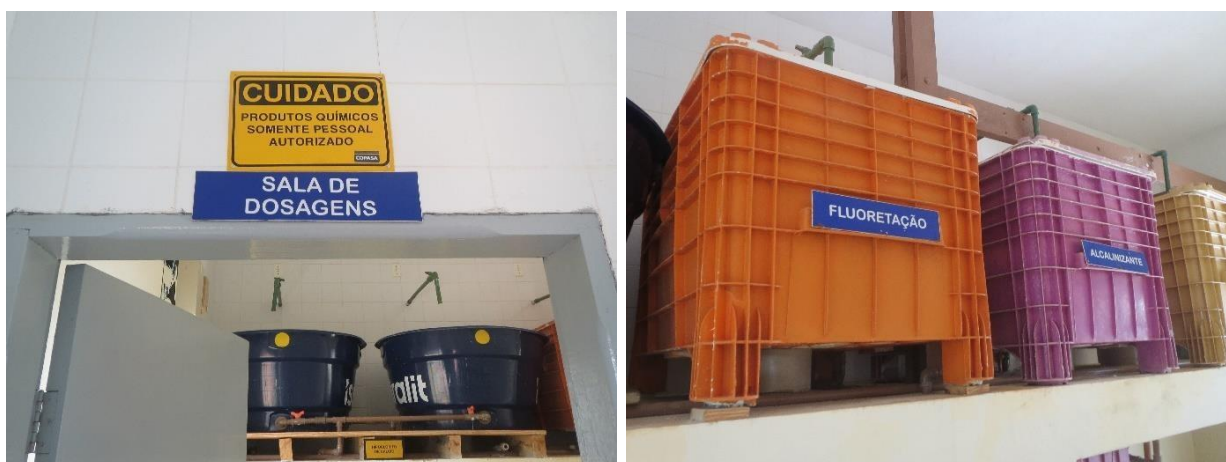
Figura 5.11: Sala de dosagem dos produtos químicos.
